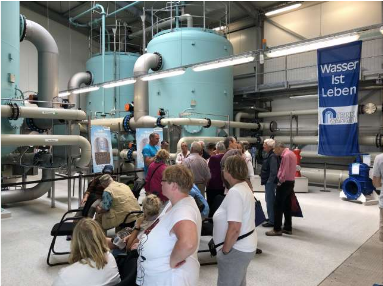
Wassermeister Frank Heckmann erläutert interessierten Bürger:innen die Trinkwassergewinnung beim Tag der offenen Tür im modernen Wasserwerk in Friedrichsgabe (Foto: Stadtwerke Norderstedt)
