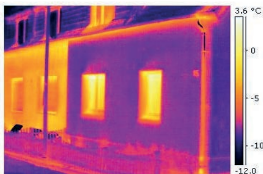
Thermografie eines gedämmten und nicht gedämmten Hauses. Allerdings wurde die Fensterlaibung nicht gedämmt.
